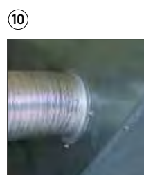
Entrada de aire exterior no estanca
